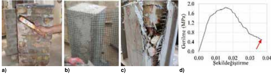
Şekil 5. Tuğla örgü üzerinde tekstil donatılı harç ile güçlendirme; a) Uygulama yüzeyinin temizlenmesi b) Güçlendirme uygulaması c) Test sonu Hasar durumu d) Eksenel yüklemeye altındaki davranış [18]
