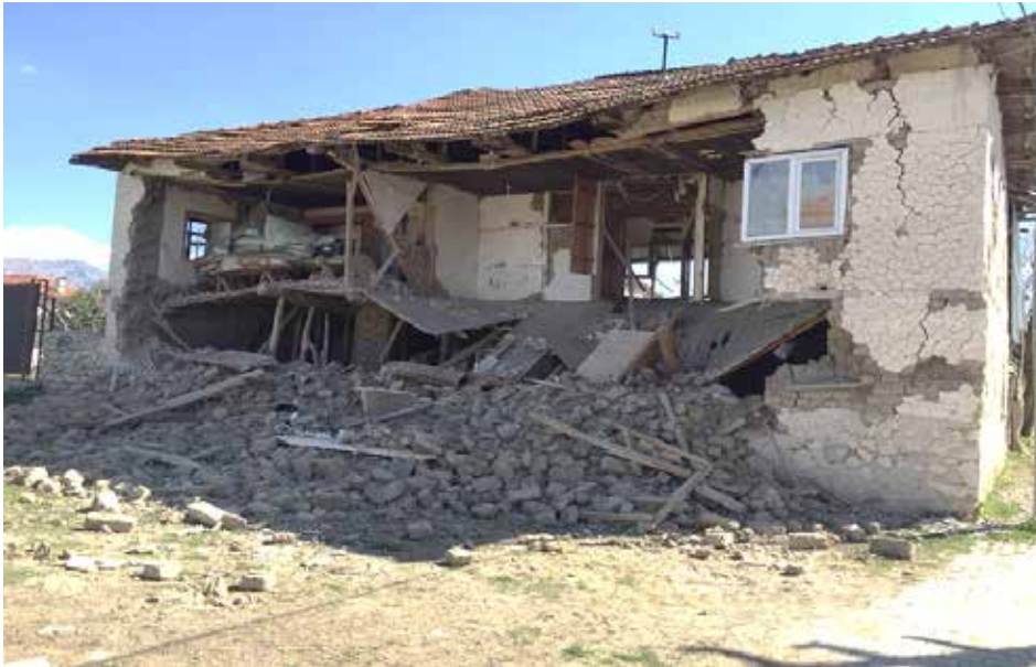
Resim 4: İki katlı kerpiç bir binada düzlem dışı duvar göçmesi, ahşap döşeme ve çatı seviyesinde rijit diyafram çalışması ortaya çıkmaması, duvar-döşeme ve duvar-çatı bağlantılarının uygun olmaması (Acıpayam-Denizli Depremi, 2019).
