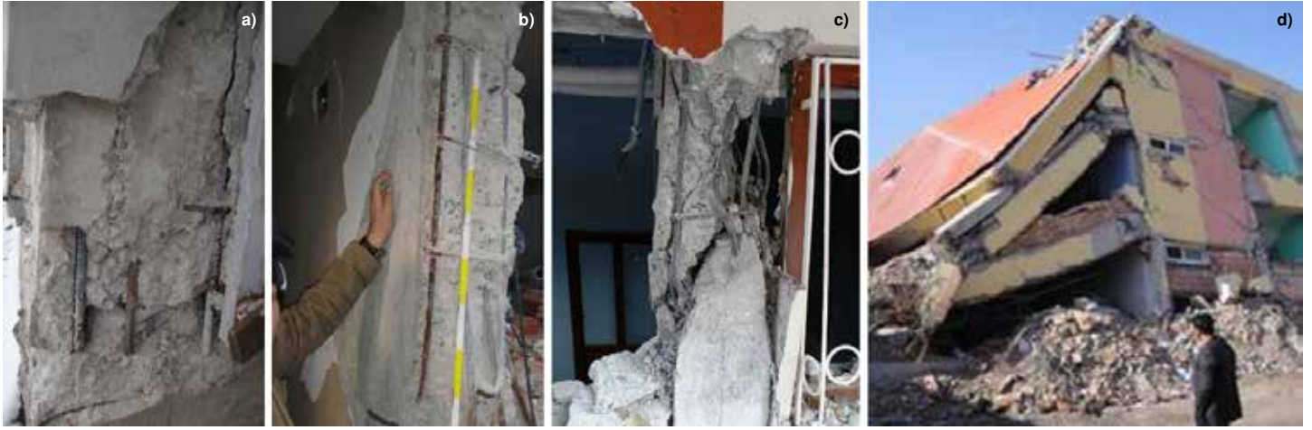
Şekil 1. a) Düşük malzeme kalitesi durumu b) Yetersiz sargılama c) Kısa kolon d) Depremde toptan göçmüş yapı
